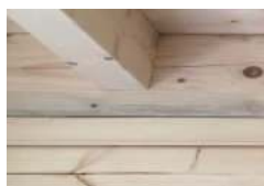
Moisissure et bleu:
